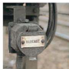
Commutateur de blocage sur mât de signal
